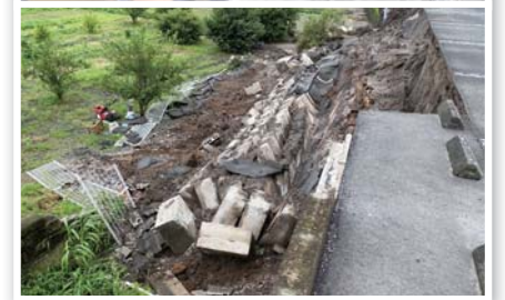
内閣府防災担当大臣と 国道269号線災害現場視察(7月豪雨)
